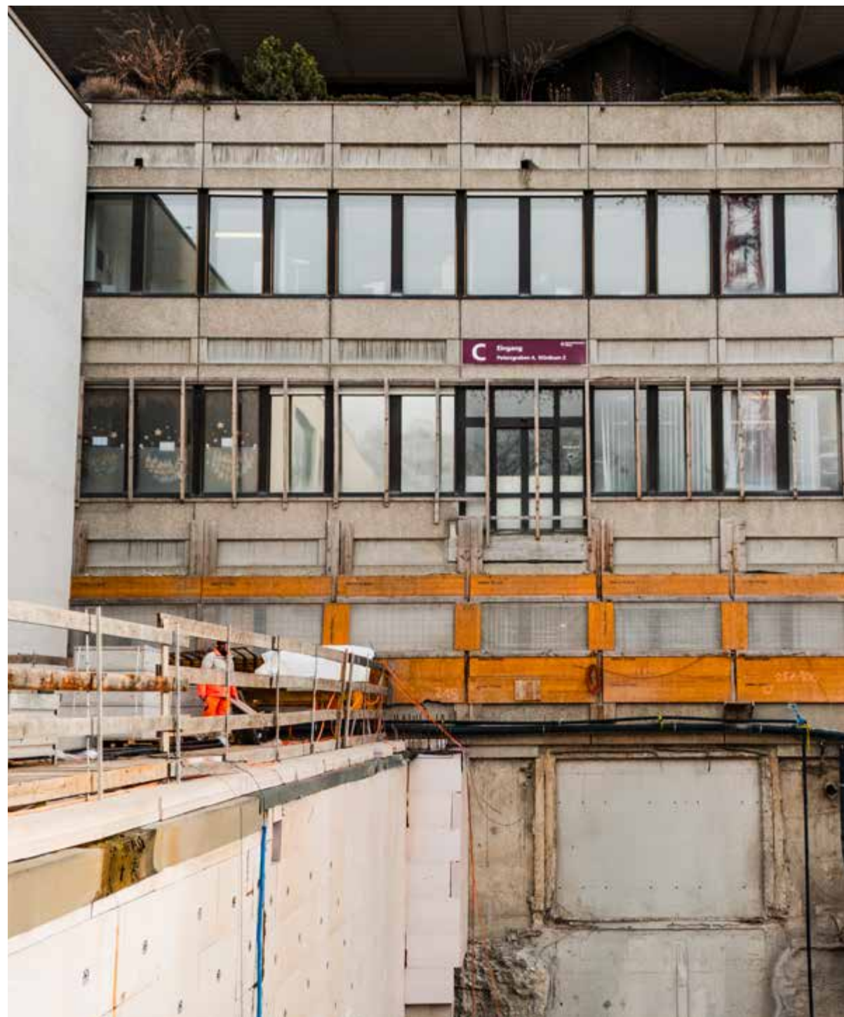
Perspektive aus der Baugrube auf den ehemaligen Eingang vom Spitalgarten her, der im Zuge der Bauarbeiten dauerhaft ausser Betrieb genommen wurde. Unterhalb ist der geschlossene Anschluss des früheren MTA-Kanals (Mitteltransportanlage) sichtbar, darunter der ehemalige Anschluss zum City Parking. Hinter dem links angrenzenden Baukörper verläuft der Verbindungsgang des Operationstrakts Ost. Ein Arbeiter bewegt sich über den neu verlegten MTA-Kanal.
